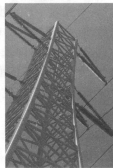
图 3 Ebert 公司的 230 kV 全复合材料杆塔
