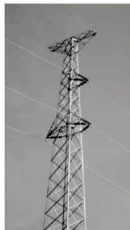
图5 福州电业局牵头开发的110 kV格构式复合材料杆塔
