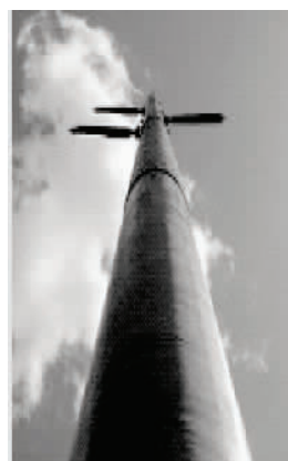
图 2 RS 公司 110 kV 直线塔
